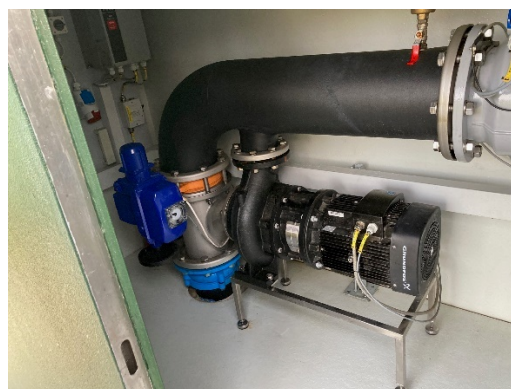
Inde i reguleringsbygværk
