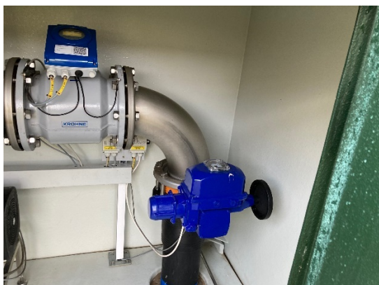
Inde i reguleringsbygværk
